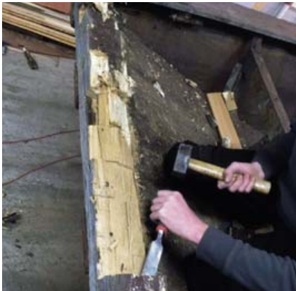
Ausschneiden von faulen Stellen (Ueli).
