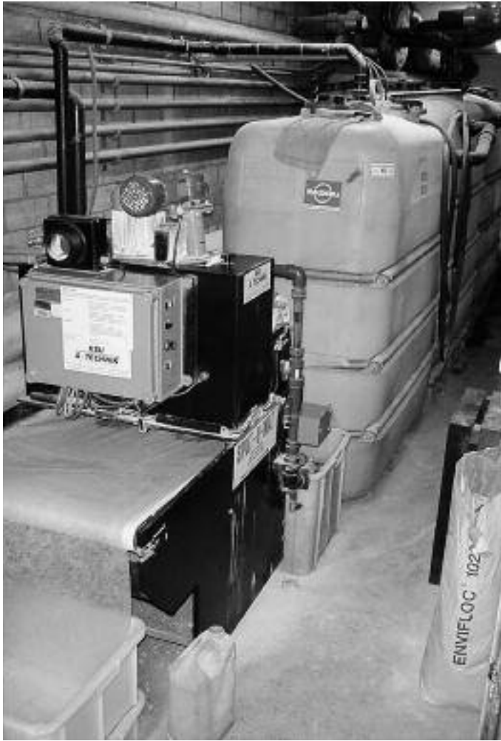
Beispiel einer Abwasservorbehandlungsanlage (im Bild eine Spaltanlage) in einem Basler Betrieb.
